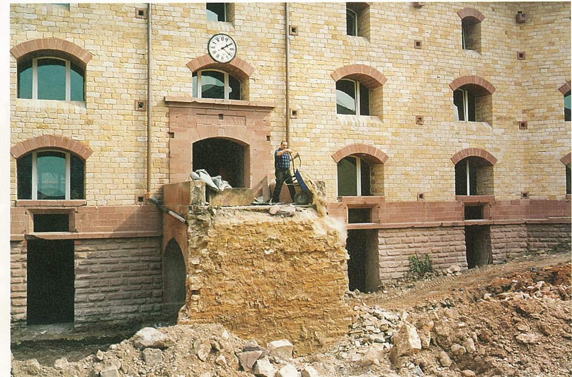
... es entstehen erhebliche Mengen Abraum, um das Niveau bis zu 3,30 m abzusenken und Platz zu schaffen für einen behindertengerechten Zugang und die Terrassenanlage.
